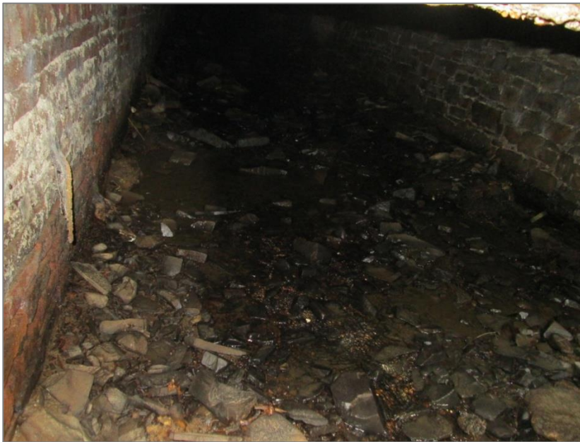
gemauerter Kasten, Ablagerungen auf der Sohle
